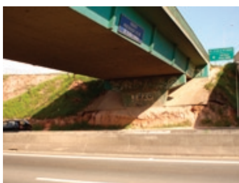
Fotos de baixo de viadutos em processo de erosão. Fonte: SOS Mata Atlântica - abr 2005.
