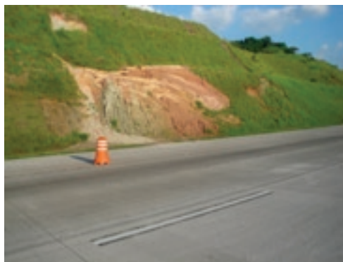
Fotos desmoronamento de terra ao longo da Faixa de Domínio. Fonte: SOS Mata Atlântica - abr 2005.
