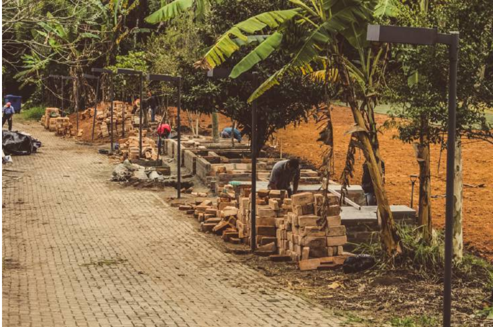
Figura 74 - Perspectiva do canteiro de obras da arquibancada e campo. Fonte: Karina Leitão, 2017.
