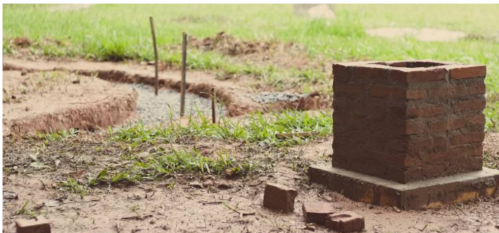
Figura 13 - Um dos três pilares de apoio do módulo três apoios. Fonte: Caetés, 2017
