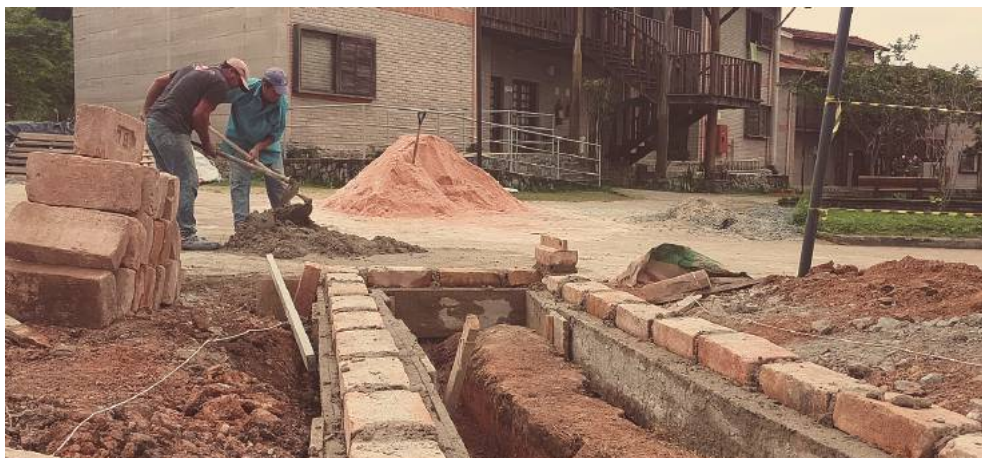
Figura 69 - Marcelo (esquerda) e Tião (direita), ambos Trabalhadores Aprendizes Voluntários, preparando argamassa para finalização da última parte da arquivancada. Fonte: Caetés, 2017
