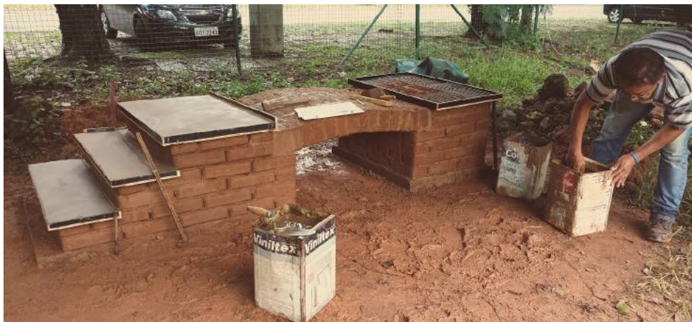
Figura 28 - Montagem e concretagem das fôrmas para os assentos do módulo arco. Fonte: Caetés, 2017
