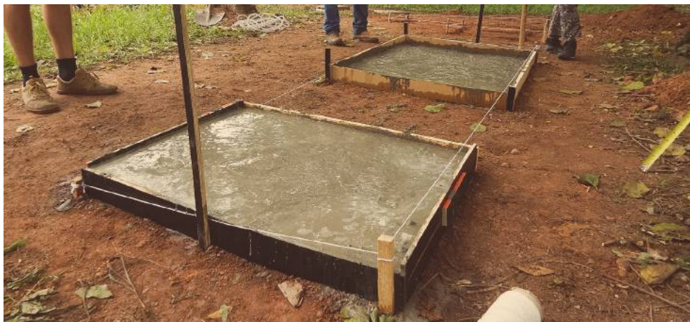
Figura 26 - Montagem e concretagem das fôrmas para fundação do módulo arcos. Fonte: Caetés, 2017
